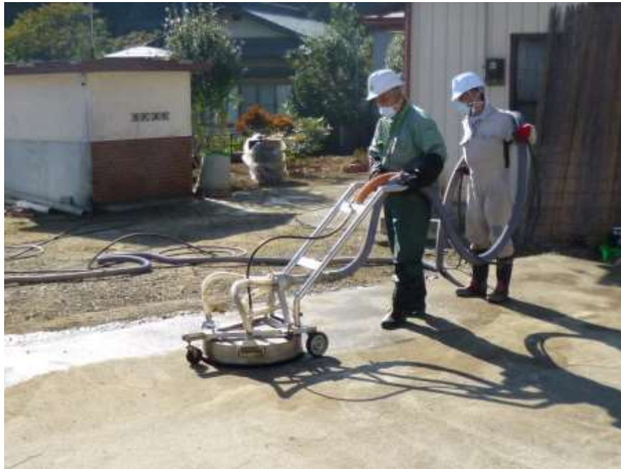
Gambar 39. Contoh dekontaminasi permukaan jalan beraspal (pembersihan air bertekanan tinggi dengan sistem pemulihan air)
